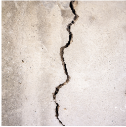
BETON ÇATLAKLARI VE DERZLER
